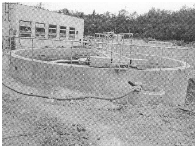
Dosazovací nádrž DN1
